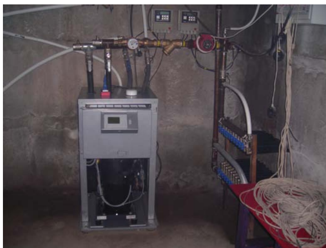
Рис. 2. Внешний вид теплонасосного узла.
